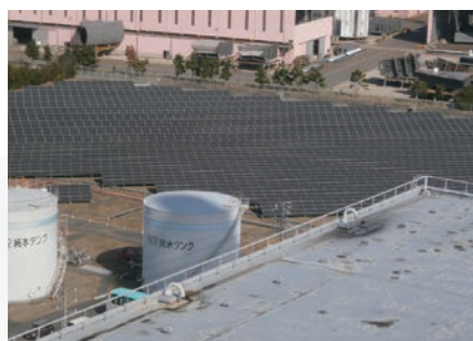
壬生川火力発電所内に設置した太陽光発電設備
