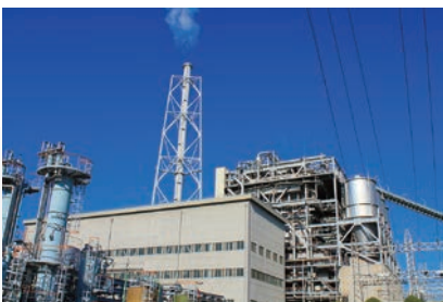
西火力発電所3号機
