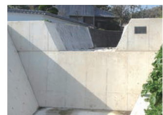
砂防堰堤 (CfFA使用)
